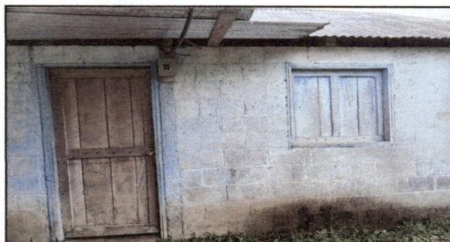
Foto 4: La puerta de Dirección del establecimiento, es necesario cambiar de madera a metal para asegurar los documentos y bienes que se encuentra dentro ella.
