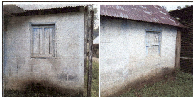
Foto 5: Las dos ventanas de la Dirección del establecimiento, están deterioradas las maderas, es importante cambiar por ventana de balcones con vidrios.
