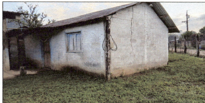
Foto 6: En la parte exterior de la pared de la Dirección del establecimiento, requiere mantenimiento por la suciedad impregnada, por lo que es necesario aplicar pintura nueva.
