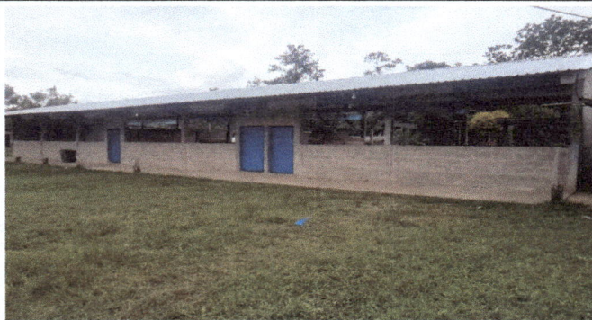
Foto 1: La falta de ventanas frente de las tres aulas, afectan a los estudiantes cuando dejan sus pertenencias dentro de las aulas.
