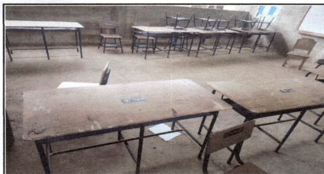
Foto 3: El piso rustico, es necesario reemplazar por piso cerámico, ya que permite la facilidad de limpieza, higiénica y estética.
